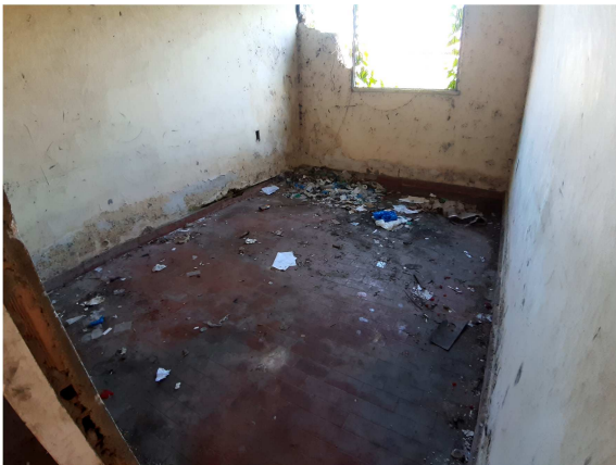
Imagem 9: Antessala – ambiente sem esquadrias, acúmulo de resíduos, alvenarias com umidade por capilaridade.
