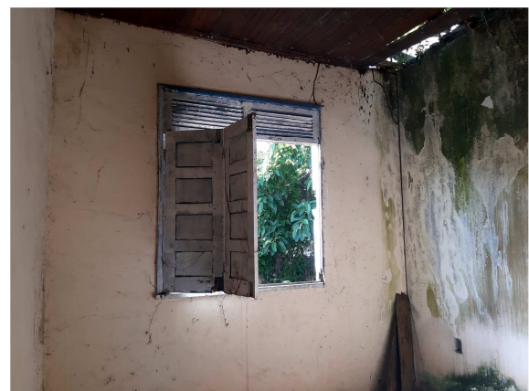
Imagem 12: Sala - ambiente sem porta instalada, fôrro com cupins, alvenarias com umidade por capilaridade.
