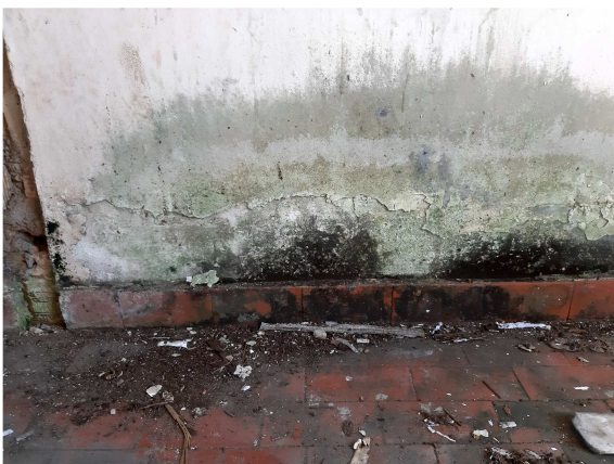
Imagem 17: Detalhe da alvenaria - umidade por capilaridade, causando patologias irreversíveis.
