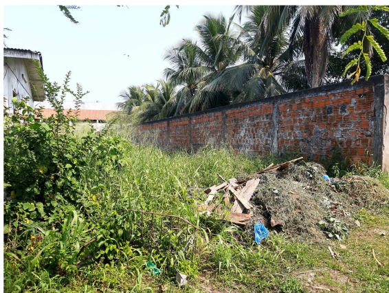
Imagem 5: Parte do muro frontal, onde provavelmente era uma entrada de garagem está com acúmulo de resíduos de construção civil.
