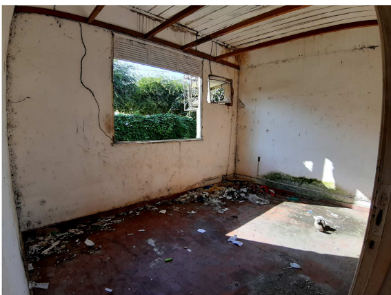
Imagem 11: Sala – ambiente sem esquadrias, acúmulo de resíduos, alvenarias com umidade por capilaridade, fôrro com cupins.
