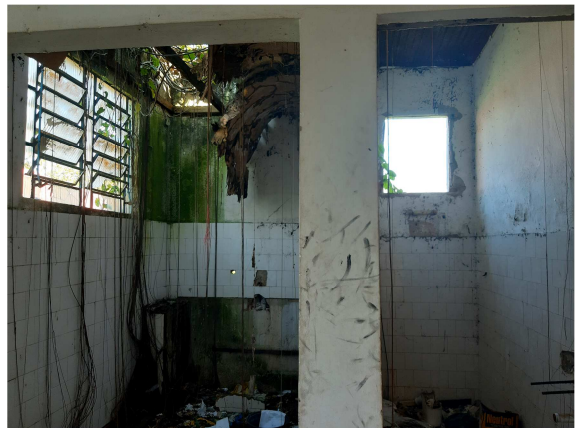
Imagem 14: Vista frontal da Copa e banheiro - área onde não há mais cobertura e fôrro.
