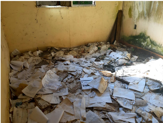
Imagem 13: Acúmulo de resíduos nas salas.
