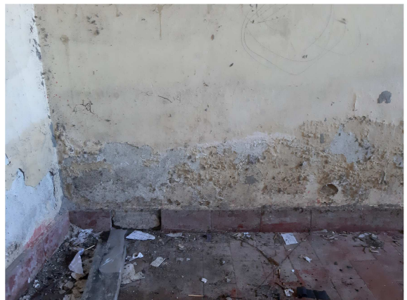
Imagem 16: Detalhe das alvenarias - umidade por capilaridade, causando patologias irreversíveis.
