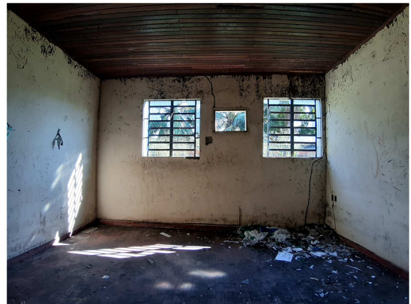
Imagem 10: Antessala - ambiente sem porta instalada, fôrro com cupins, acúmulo de resíduos, alvenarias com umidade por capilaridade.
