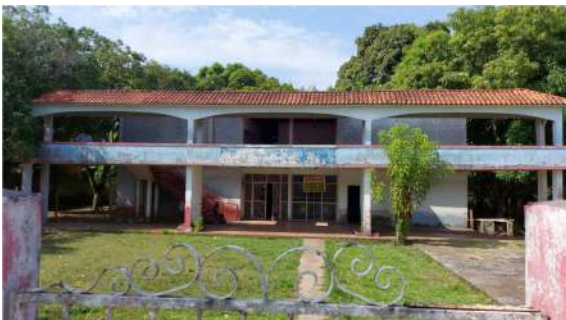
Imagem 23: IMÓVEL 6 – Misto (residencial e comercial), localizado na Av. Pedro de Moura, N° 824, Bairro Terra Preta. Estado de conservação péssimo, com instalações precárias.
