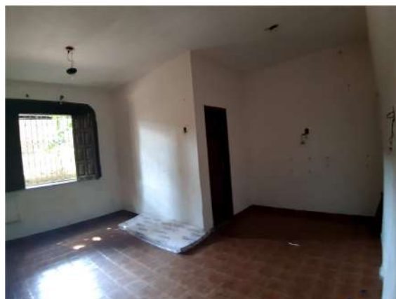
Imagem 30: IMÓVEL 3 – Pavimento Térreo – Quarto. Edificação com energia elétrica irregular.
