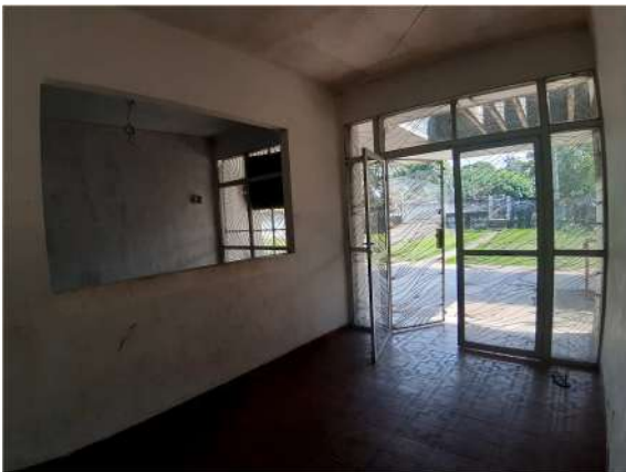
Imagem 27: IMÓVEL 6 – Pavimento Térreo – duas salas/recepção. Edificação com energia elétrica irregular.
