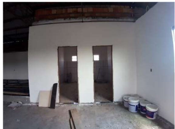
Imagem 12: IMÓVEL 2 – Banheiro Feminino com duas bacias sanitárias e Banheiro Masculino com bacia sanitária e mictório.
